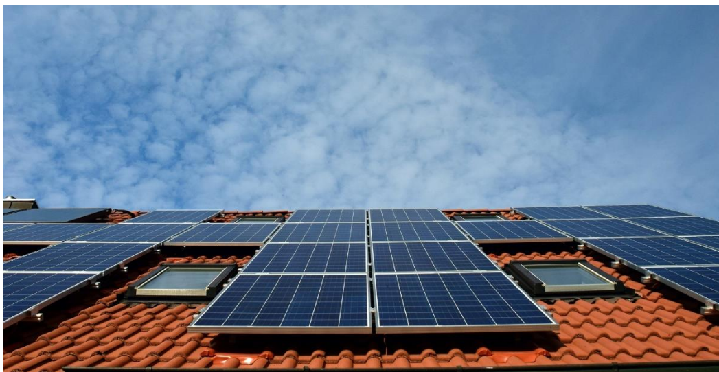
Figura 7: Sistema de placas solares
